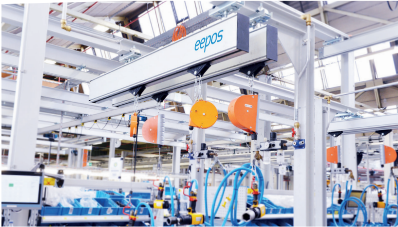
eepos Profile mit Fahrwerk in der Fendt Traktorenvormontage
